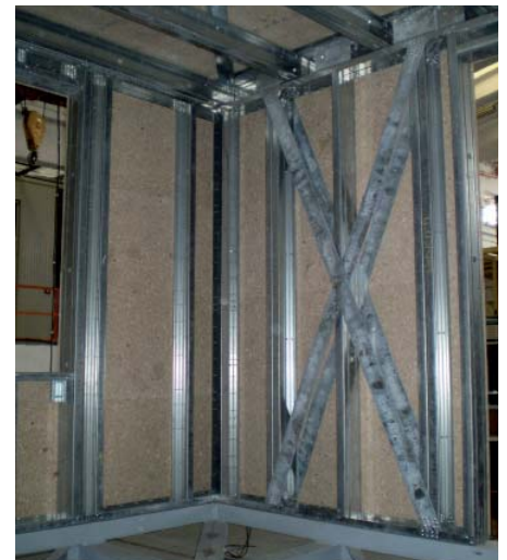
Acélszalagos merevítés az ajtónyílás mellett
